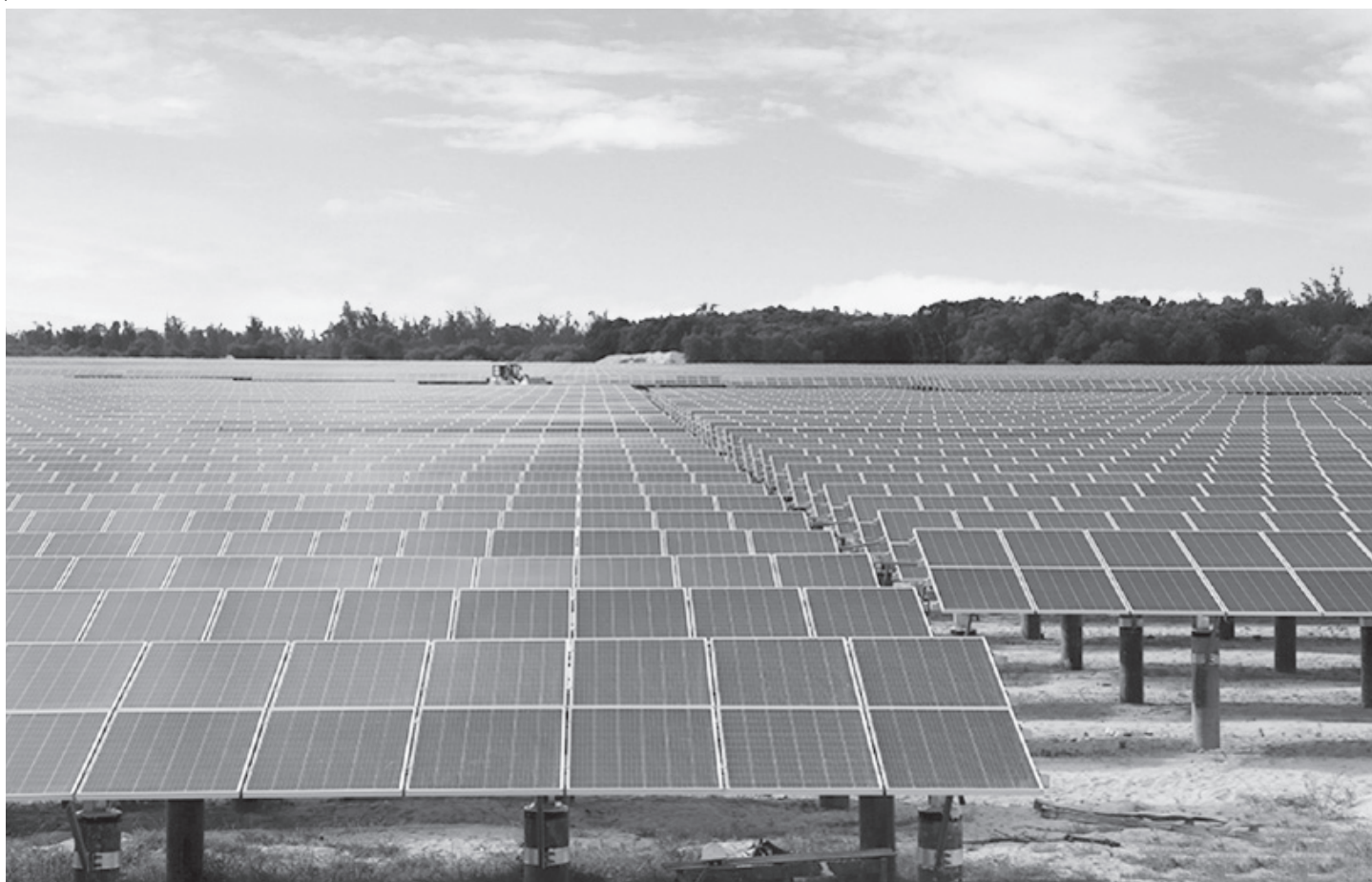
1 góc Nhà máy điện mặt trời Cẩm Hòa
