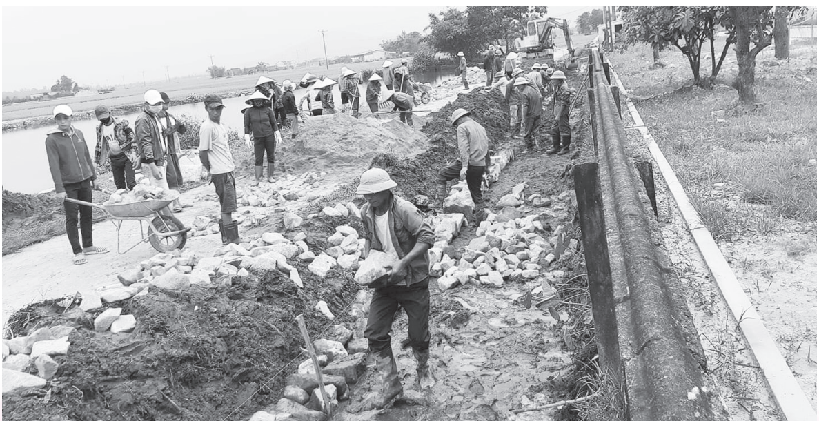
Nhân dân thôn Tiến Thành xã Kỳ Khang ra quân xây dựng rãnh thoát nước, khu dân cư nông thôn mới kiểu mẫu Ảnh: L.V.T
